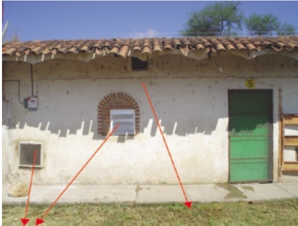
Ventilas de fuga de presión
